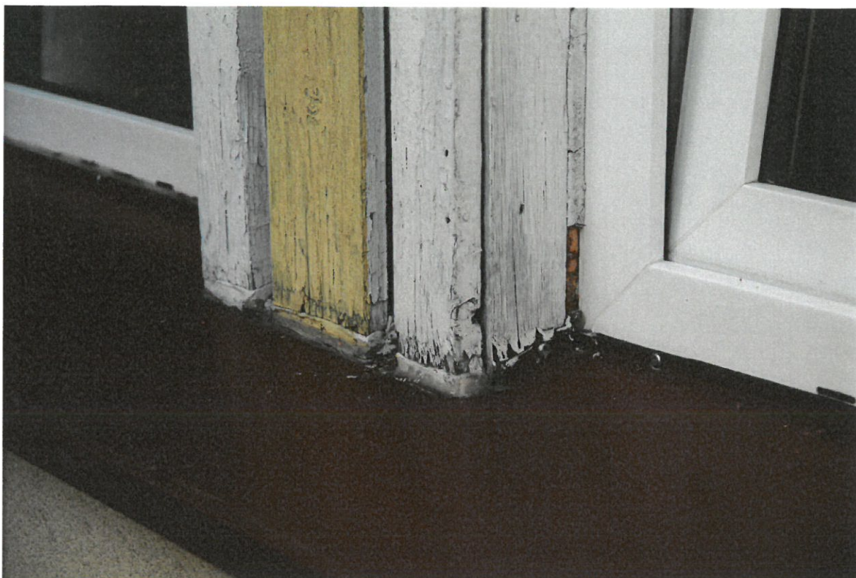
Uszkodzenia elementów konstrukcyjnych ścian zewnętrznych
