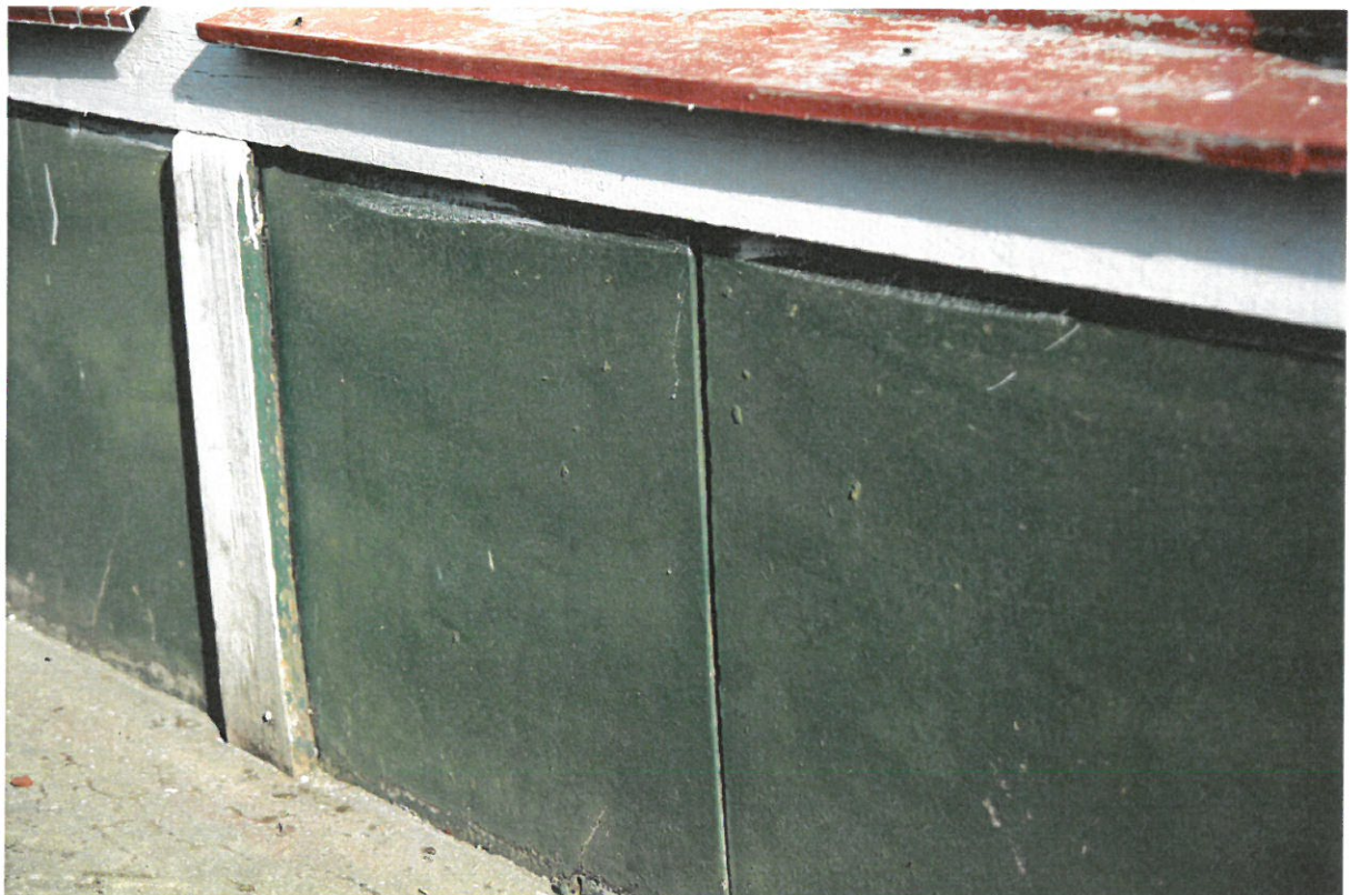
Uszkodzenia poszycia zewnętrznego ścian
