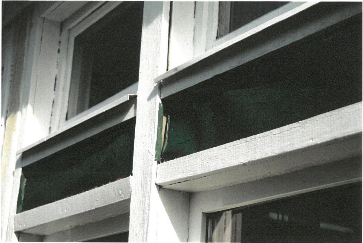
Uszkodzenia poszycia zewnętrznego ścian
