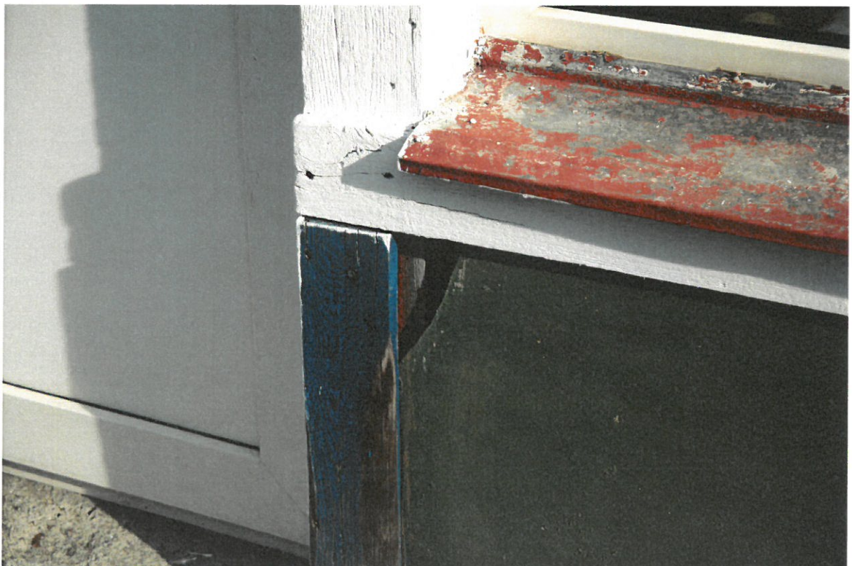
Uszkodzenia poszycia zewnętrznego ścian
