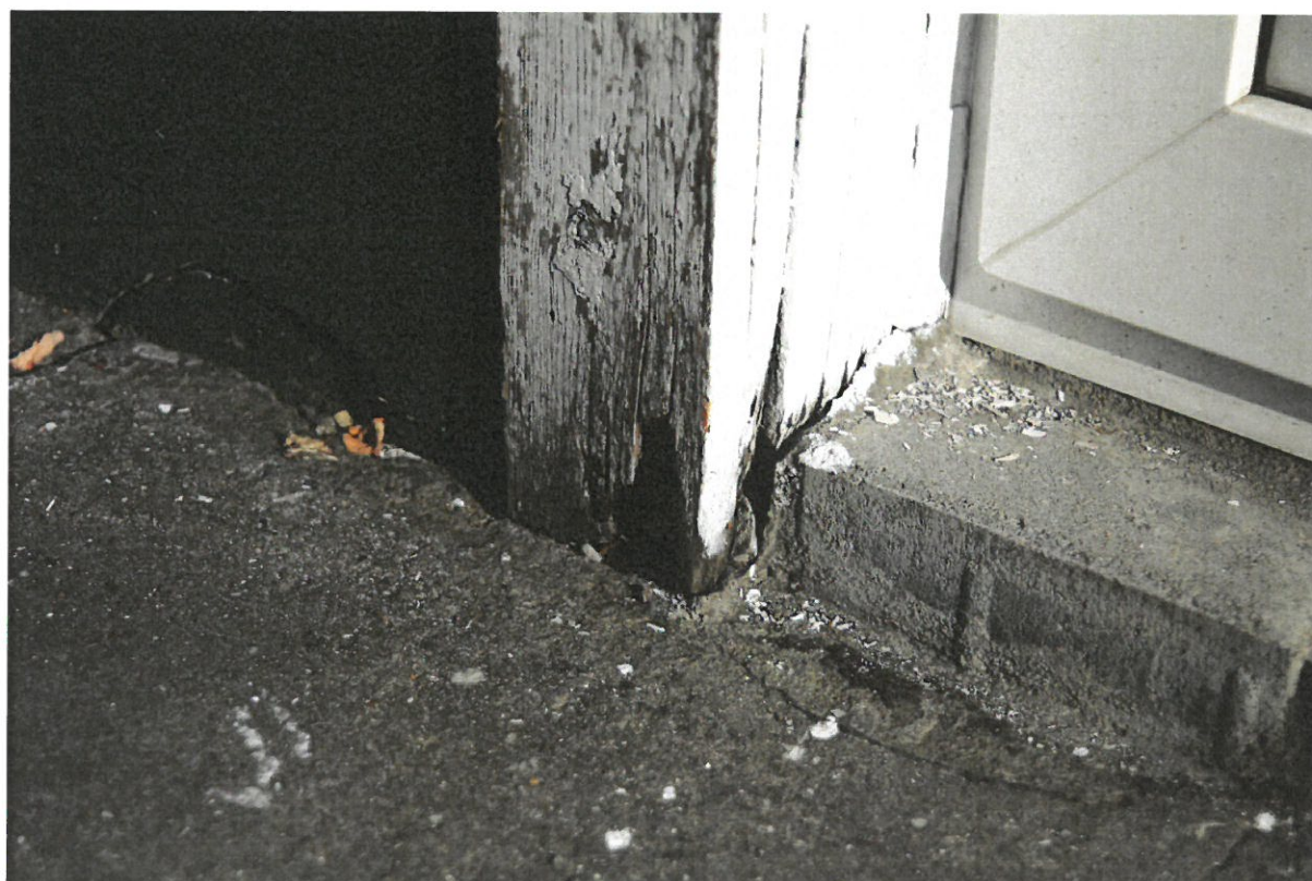
Uszkodzenia elementów konstrukcyjnych ścian zewnętrznych
