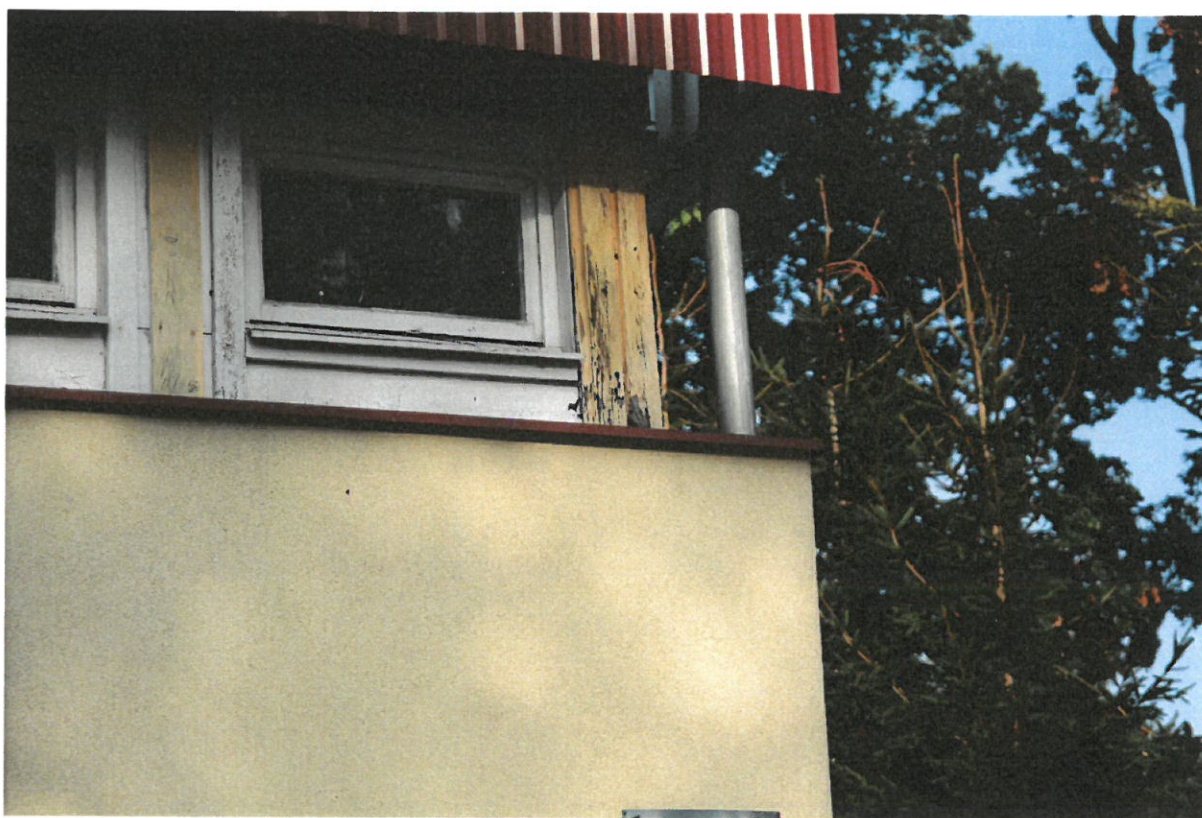
Uszkodzenia elementów konstrukcyjnych ścian zewnętrznych
