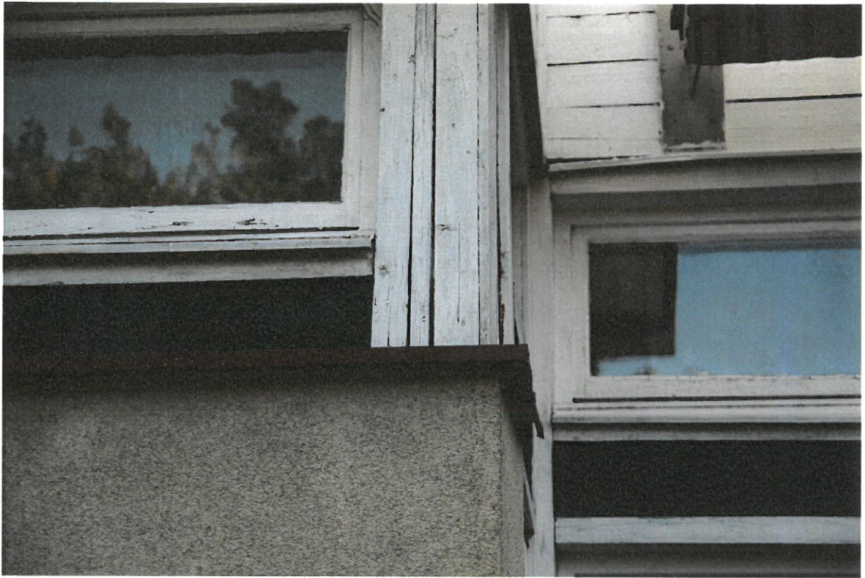
Uszkodzenia elementów konstrukcyjnych ścian zewnętrznych
