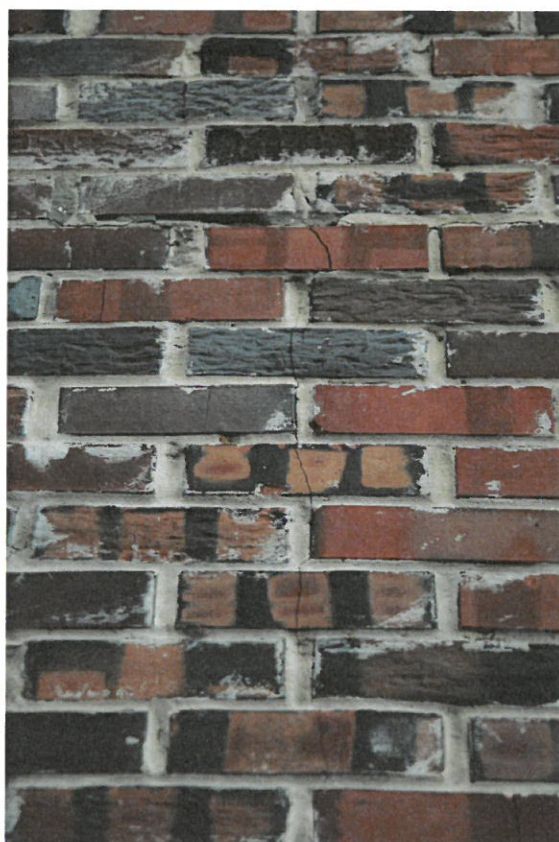
Uszkodzenie komina zewnętrznego
