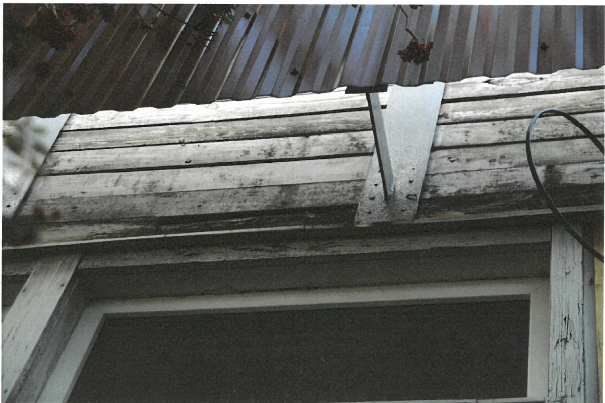
Uszkodzenia obudowy dachu
