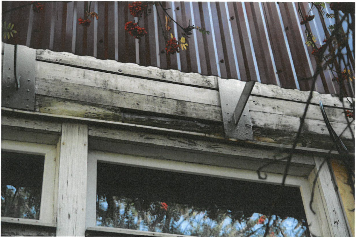
Uszkodzenia obudowy dachu
