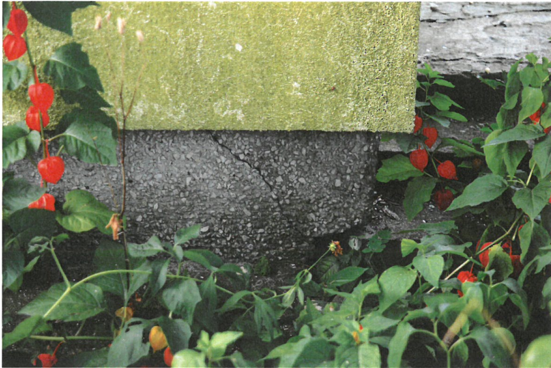
Uszkodzenie narożnika ściany fundamentowej
