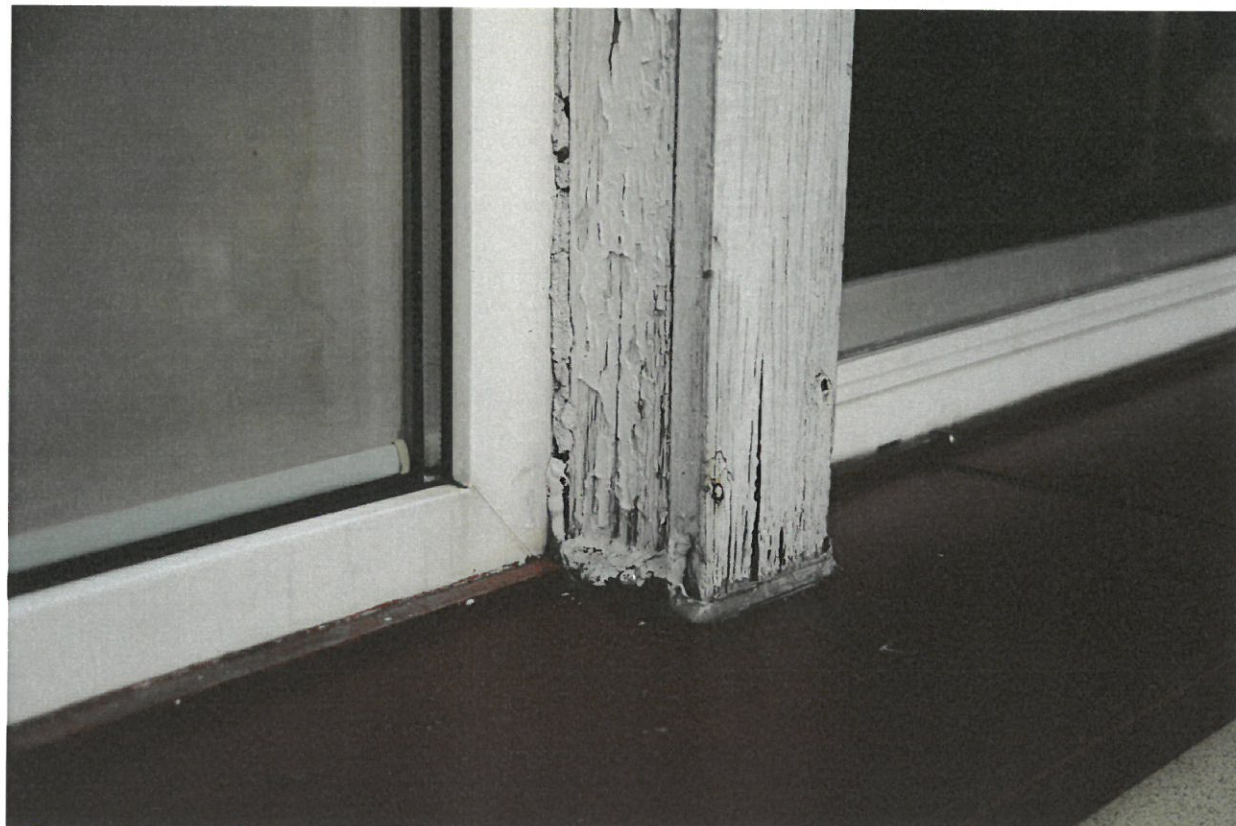
Uszkodzenia elementów konstrukcyjnych ścian zewnętrznych
