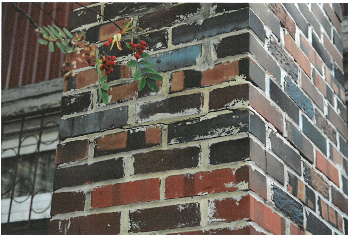
Uszkodzenie komina zewnętrznego
