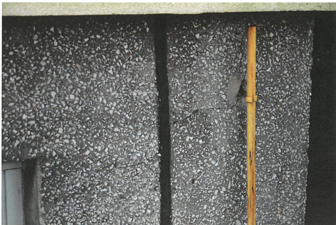
Uszkodzenie narożnika ściany fundamentowej
