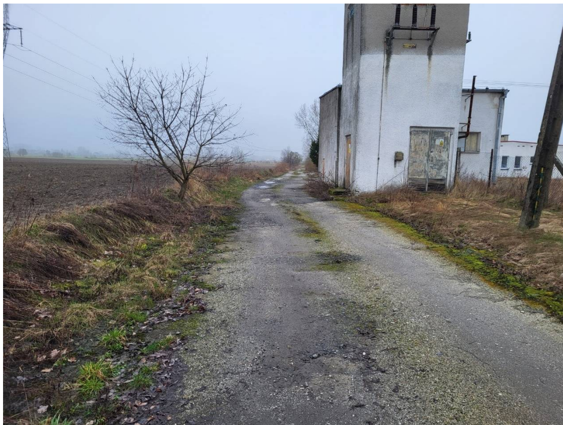
Zdjęcie 3 Stan istniejący drogi
