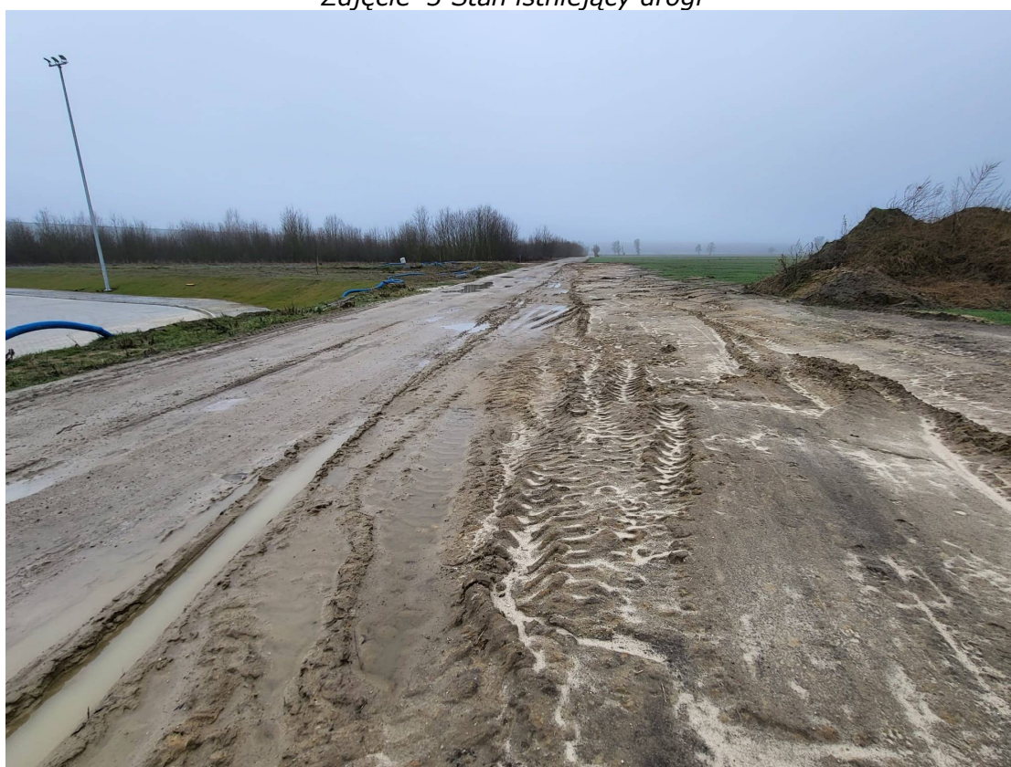
Zdjęcie 4 Stan istniejący drogi
